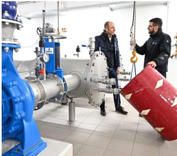
Remo Schnyder (rechts) und Anton Sax zeigen im Wasserwerk Kesswil, wie ein „Molch“ in das Rohrleitungssystem zur Muschel-Bekämpfung eingesetzt wird. Foto: Felix Kästle/dpa
